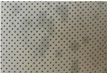
Flecken durch eingezogene Feuchtigkeit.
