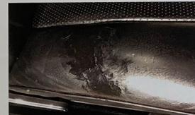
Aufgefüllter Riss, ungeglättet.
