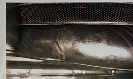
Aufgefüllter geglätteter Riss.
